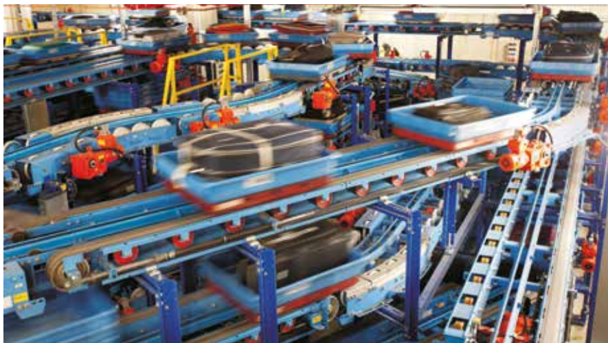
Die Gepäckförderanlage am Flughafen Frankfurt bewegt täglich enorme Mengen an Reisegepäck. Mit einer zentralen Visualisierung modernisiert Fraport die Steuerung und Überwachung des komplexen Systems.
