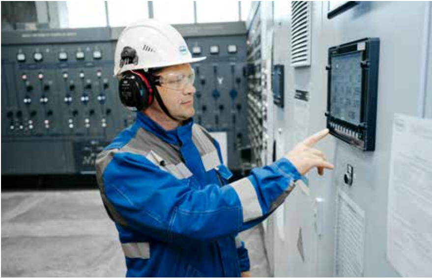
HMI-Lösungen bei industriellen Energieanwendungen
