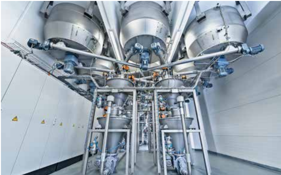
Automatische Mittelkomponentenanlage mit Wiegesystem
