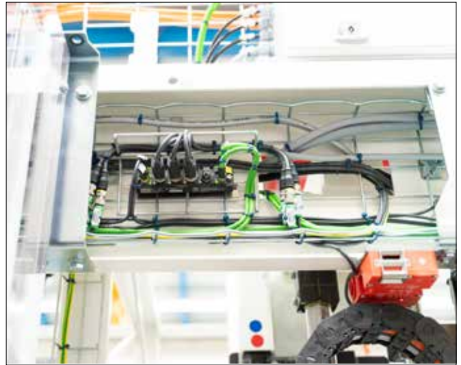
Die Vielfalt der Turck I/O-Module und die Abdeckung aller benötigten Signaltypen war mit ausschlaggebend für die Zusammenarbeit.
