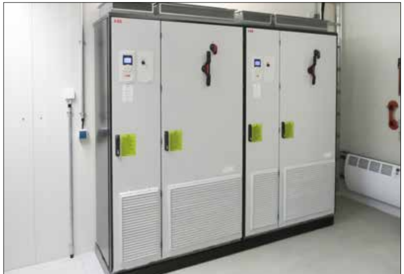
Vier Multidrive-Frequenzumrichtersysteme ACS880 von ABB sorgen für den Gleichlauf der Motoren.
