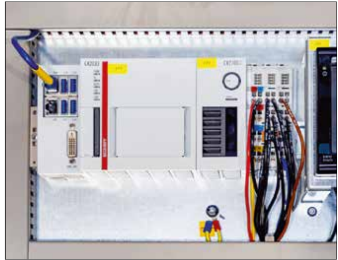
Bei den Power Plant Controllern (PPC) werden Embedded-PCs CX2033 mit AMD Ryzen Prozessor eingesetzt sowie über TwinCAT und ADS die einzelnen Power Blocks gesteuert.
