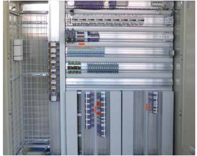
Steuerungsschaltschränke für die Fernwirkungsanlagen der BLT
