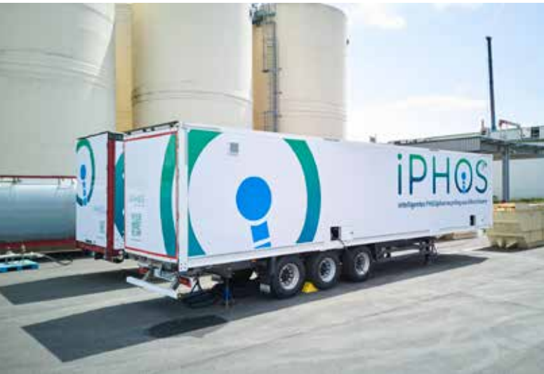
Die mobile Phosphorrückgewinnungsanlage von SF-Soepenber basiert auf einem innovativen Verfahren.
