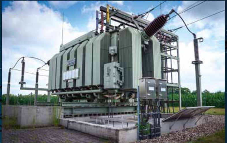
Elf Umspannwerke in der Emscher-Lippe-Region mussten mit neuesten Kommunikations- und Steuerungssystemen ausgestattet werden.
