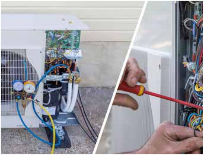
Unterschiedliche Anschlussstechniken und -punkte erhöhen das Risiko von Installationsfehlern.
