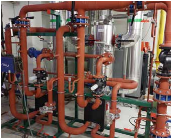
Die Umstellung auf eine neue, mit Biomasse betriebene Wärmeleitung vermeidet 260 Tonnen CO 2 pro Jahr.
