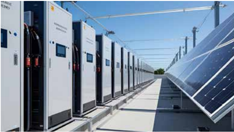
Batteriespeicher in Verbindung mit Photovoltaik-Anlagen bieten für Industrie und Gewerbe eine praktische und wirtschaftliche Möglichkeit der Eigennutzung des erzeugten Stroms.
