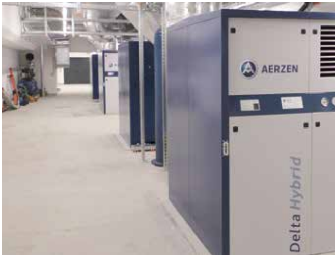
Aerzen-Drehkolbenverdichter vom Typ Delta Hybrid D 52S sorgen für die optimale Sauerstoffversorgung der fünf SBR-Reaktoren.
