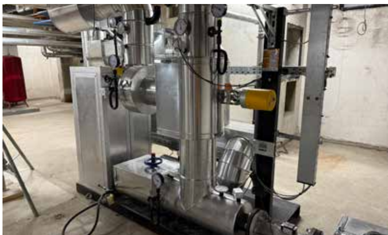
Wärmeübergabestation Moduline von Baelz: Die verschleißarme und energieoptimierte Einheit ist auf einen dauerhaften, effizienten Betrieb ausgelegt und erfüllt höchste betriebliche Standards.
