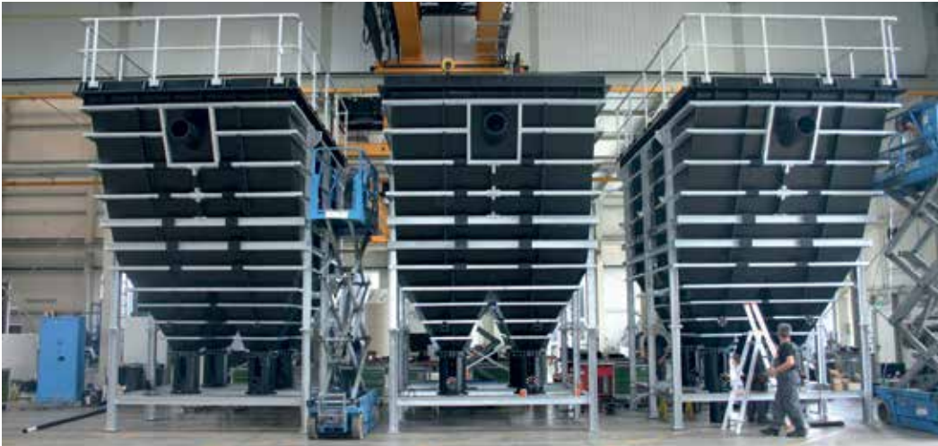
Vom Engineering bis zur Errichtung ganzer Tanklager fur den Chemiegrohandel sowie die Vorbehandlungsanlagen fur die Feuerverzinkungsindustrie gehoren zu den Kernsegmenten von Weber Kunststofftechnik.
