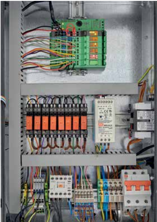
Im Slave-Schaltschrank nutzt Elektro Ecker die modulare Kleinsteuerung ILC 131 ETH (Bild oben).
