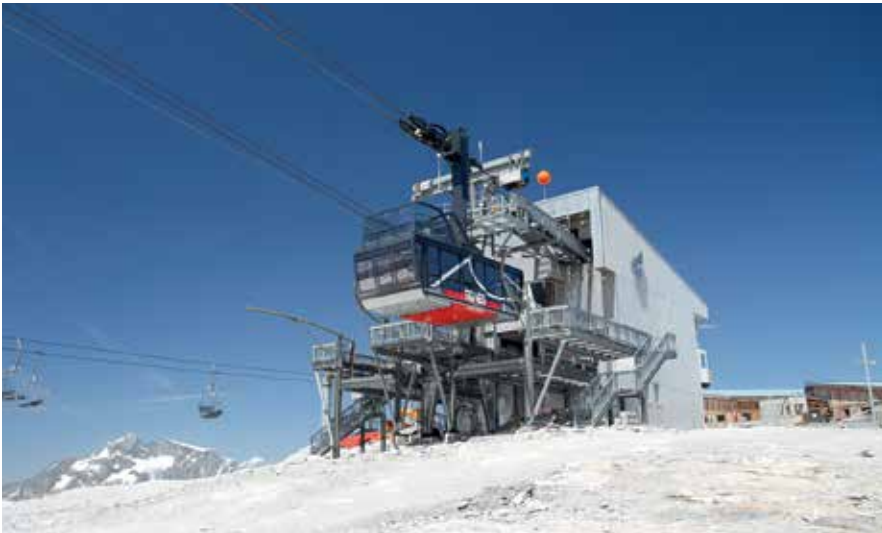
Die gesamte Antriebstechnik inklusive der 150 Tonnen schweren Tragseilspanngewichte ist auf 3.038 Metern Höhe in der Talstation der Téléphérique de la Grande Motte untergebracht.
