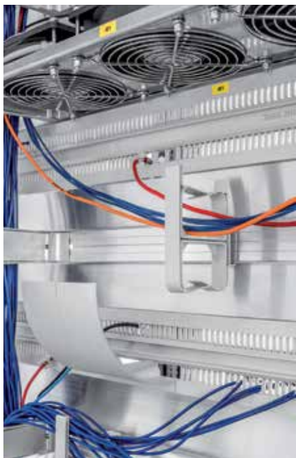
Rückseitenansicht des Verdrahtungsrahmens mit Airblower (oben) und Airblade (nach oben gebogenes Bauteil am unteren Raster), die eine gezielte Kühlluftführung auf die Komponenten der Vorderseite ermöglichen.
