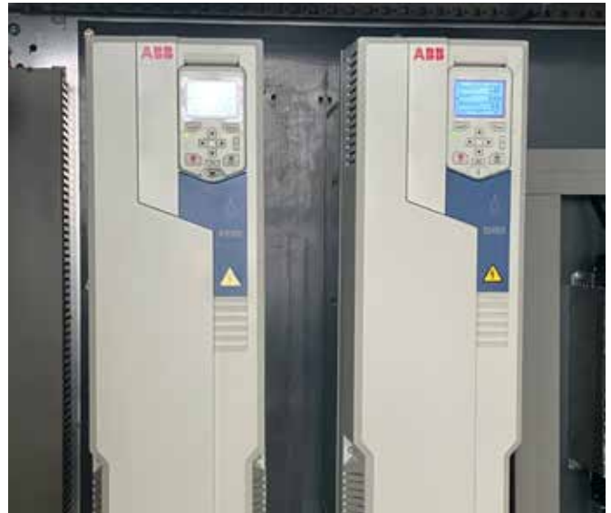
Speziell für den Wasser- und Abwasserbereich konzipierte ACQ580-Frequenzumrichter regeln die neuen Motoren.
