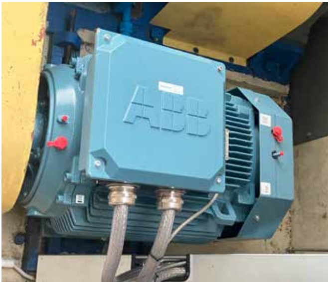
Insgesamt drei ABB-Synchronreluktanzmotoren mit Ultra-Premium-Effizienz IE5 wurden installiert.
