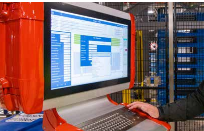
Alarmer werden übersichtlich dargestellt und können zentral bearbeitet werden.
