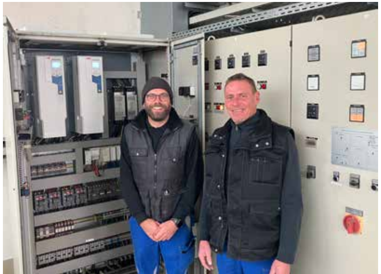
Betriebsleiter Bernd Ebe (rechts) und Elektriker Markus Siegler (links) vor dem Schaltschrank mit den beiden Single Drives ACQ580-01 für die Schneckenpumpen.
