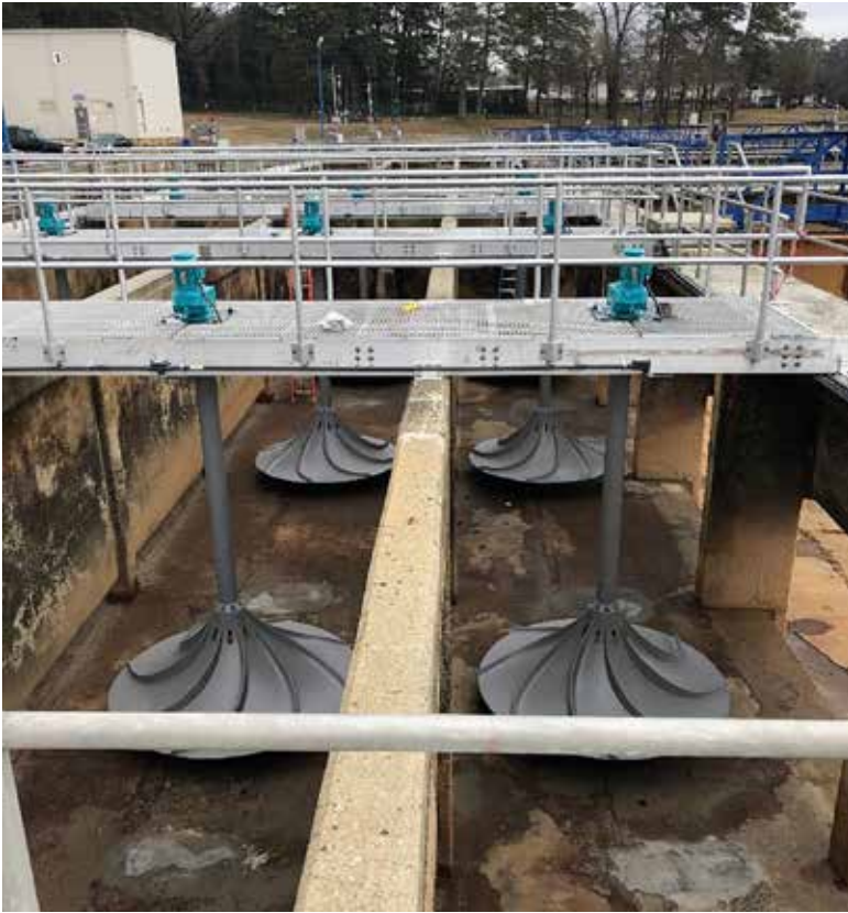
Nach der Umrüstung: Hyperboloid-Flockungsrührwerke.
