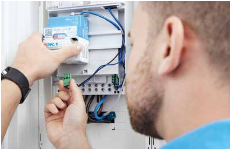
Das Voltaris-Sicherheitskonzept zur neuen MSB-Lieferkette erfüllt die BSI-Vorgaben zur sicheren Auslieferung und Installation der intelligenten Messsysteme.
