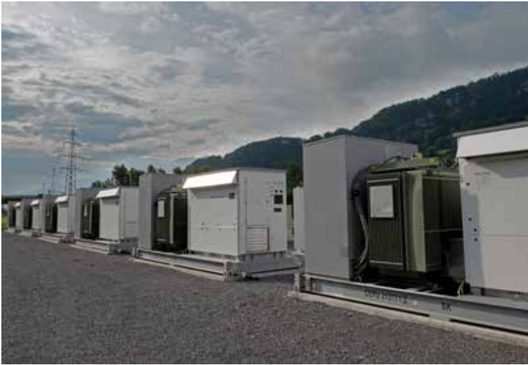
Teilansicht der Megabatterie in Walenstadt
