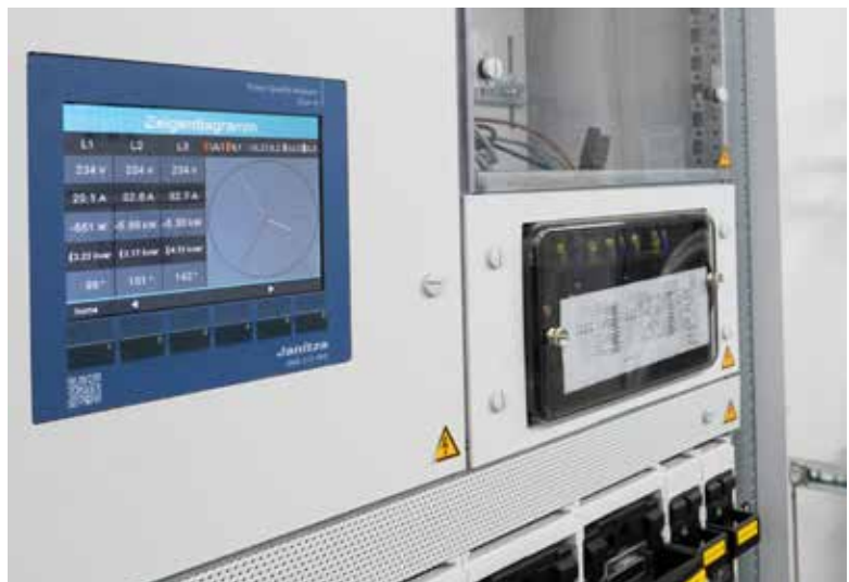
Der Klasse A Spannungsqualitätsanalysator UMG 512-PRO in einer Trafostation des Batteriespeichers
