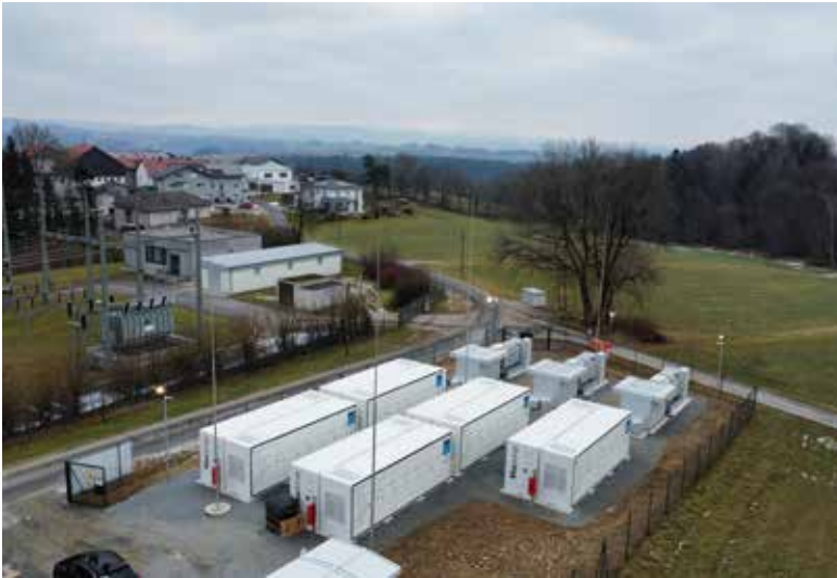
Projekt in Tittling, Deutschland: Co-Location-Projekte bieten nachhaltige Energie und Netzflexibilität.
