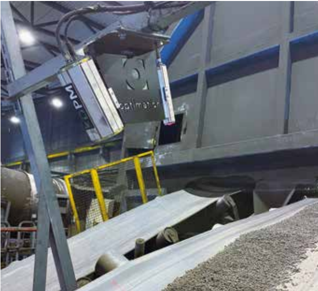
Das 3DPM wurde für raue Industrieumgebungen entwickelt und verwendet die 3D-Vision-Kamera Ranger3 von Sick zur Messung der Partikelgrößenverteilung auf breiten Hochgeschwindigkeits-Förderbändern.
