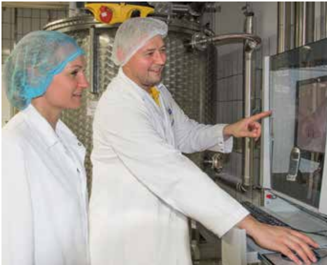
Das räumliche Versetzen einer Produktionsanlage nutzen die Elektrokonstrukteure von Ritter Sport unter Leiter Peter Schetter (hier im Gespräch mit Nancy Locher von Murrelektronik) für ein Retrofit.
