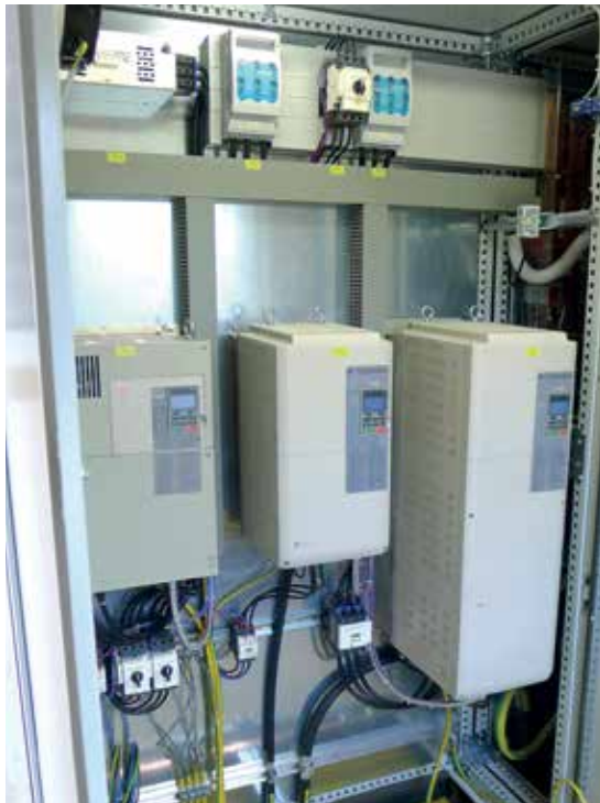
Drei Umrichter füllen einen Schaltschrank gerade mal zur Hälfte: Zwei U1000 und ein A1000.
