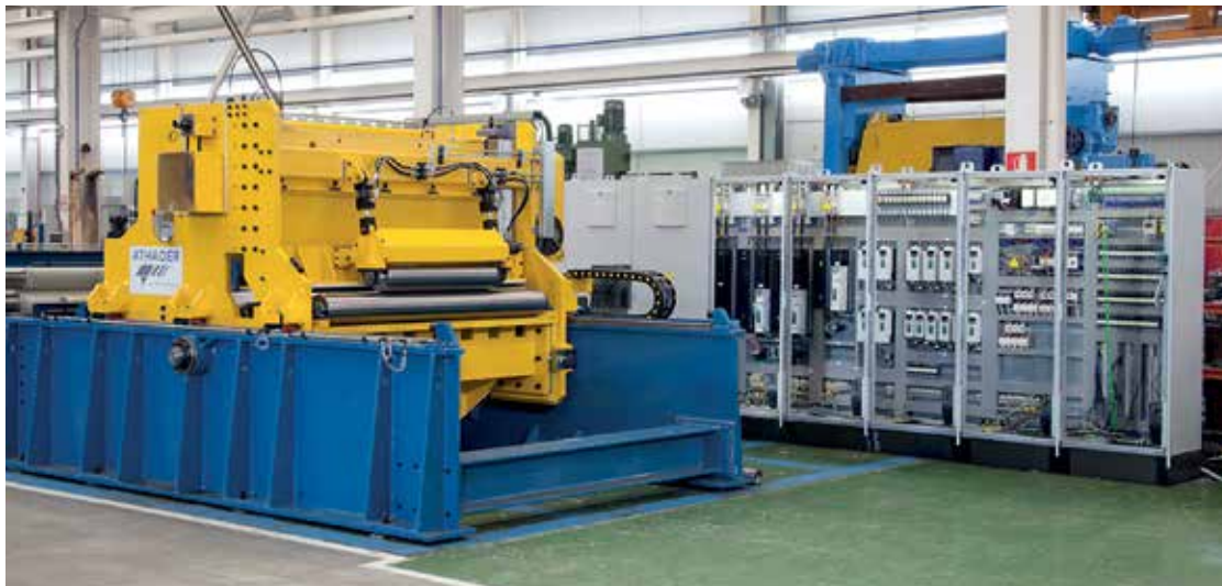
In der neuesten Querschneidelinie für Stahlbänder sorgen Lösungen von Control Techniques für optimierte Maschinenkonzepte.
