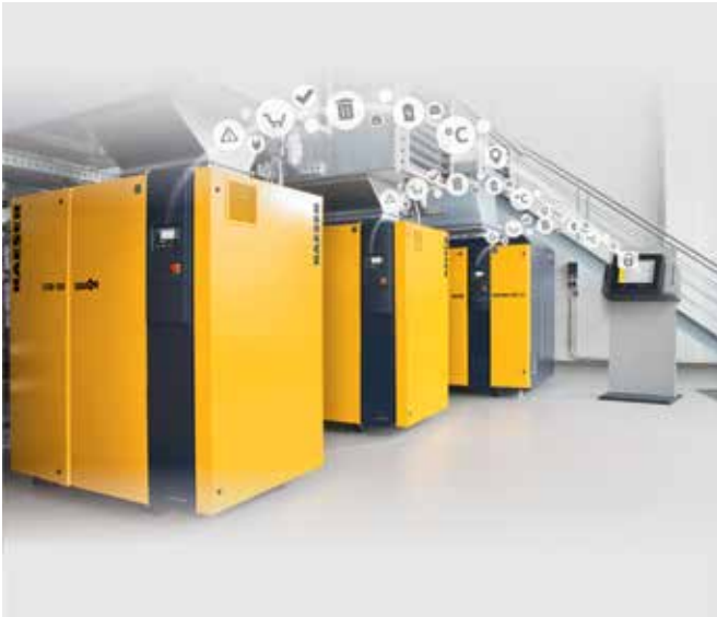
In der Druckluftstation kommunizieren die einzelnen Komponenten zur Druckluftherzeugung mit der übergeordneten Steuerung.
