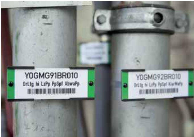
Gut lesbare Markierungen sind der Schlüssel zur Maintenance 4.0
