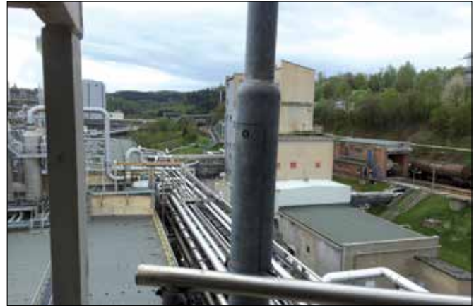
Über rund vier Kilometer Edelstahl-Rohrleitungen wird die Druckluft auf dem weitläufigen Firmengelände verteilt.
