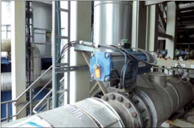
Für das bloße Auge nicht erkennbar: Über diese defekte Verschlusschraube am Stellantrieb entweicht Druckluft.
