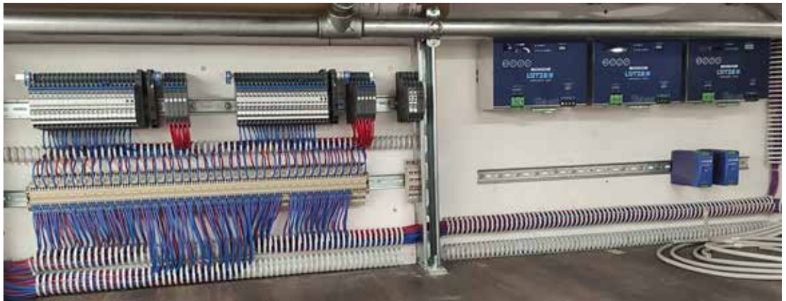
Stromversorgung und -überwachung des Abschnitts Südamerika im Aufbau
