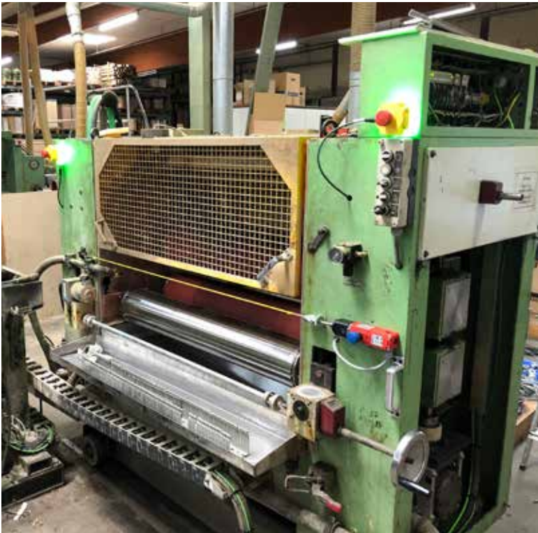
Retrofit einer Kaschieranlage aus dem Jahre 1996: Unter anderem kommen darin nun Seilzugschalter und beleuchteten Not-Halt Geräte von Bernstein in einer elektronischen Sicherheitskette zum Einsatz.
