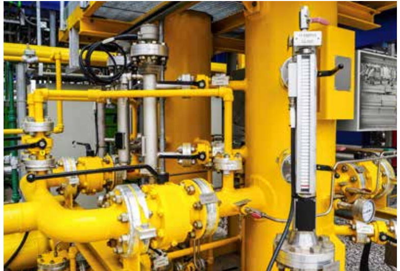
Erdgasversorgungs- und -verteilerstation mit einem Netzwerksegmentierungs- und Fernzugriffsschaltsschrank gemäß IEC 62443 von Phoenix Contact.
