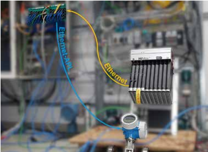
Testaufbau bei BASF: die weltweit erste SIL-3-Kommunikation über Ethernet-APL.
