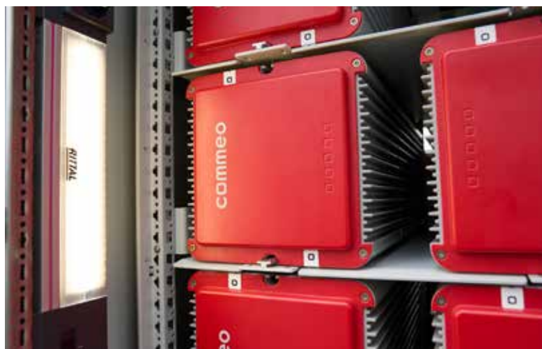
Durch das VX25 Schaltschranksystem lassen sich die schweren Batteriesysteme von Commeo problemlos einbauen.
