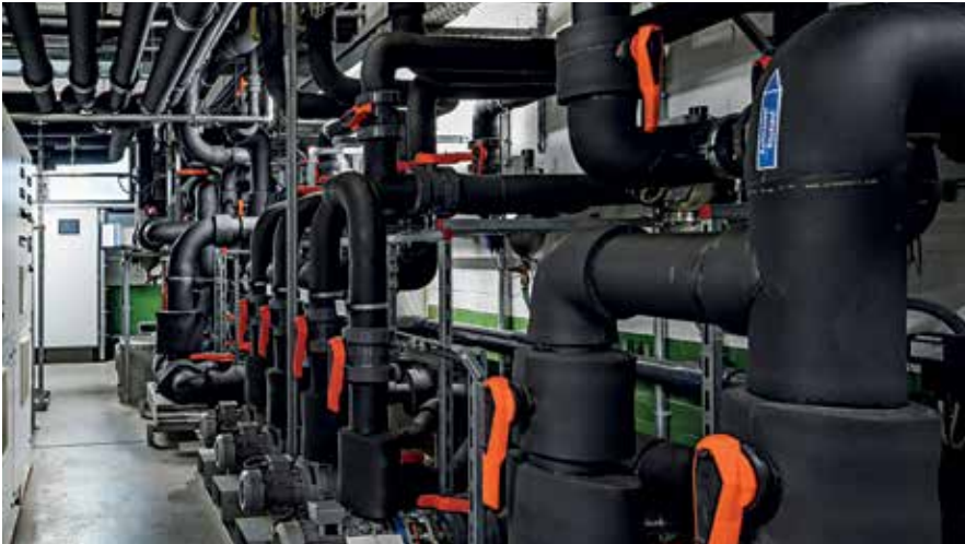
Mit 80 Messpunkten war im Wago Werk Sondershausen bereits viel an Bestandsmessung vorhanden. Fehlende Daten wurden mit mobilen Messungen abgedeckt.
