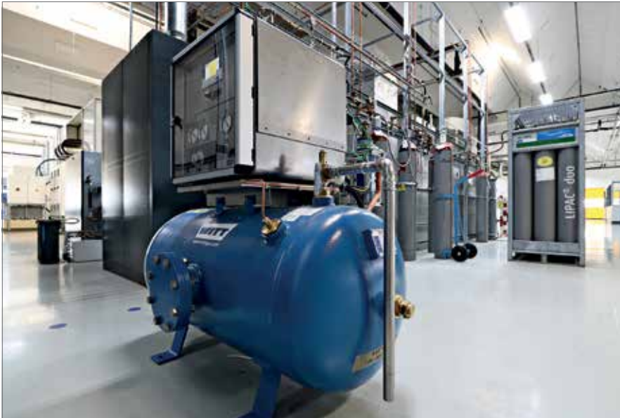
Der Gasmischer für Helium und Stickstoff ist in die Gasstation eingebunden. Während das Helium noch über Flaschen bereitgestellt wird, erzeugt Kendrion den Stickstoff nun selbst.
