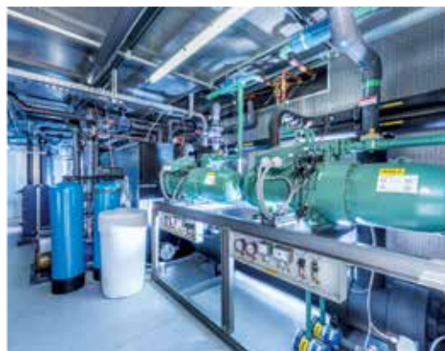
Split-Kälteanlage für einen Kunststoffverarbeiter.
