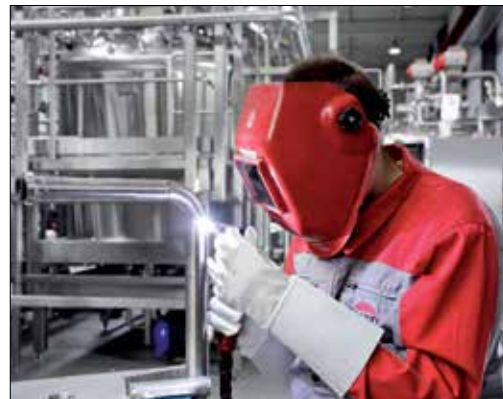
Anlagenbau von der Planung zur Inbetriebnahme
