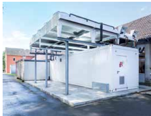
Containeranlagen sparen Platz in der Produktion.
