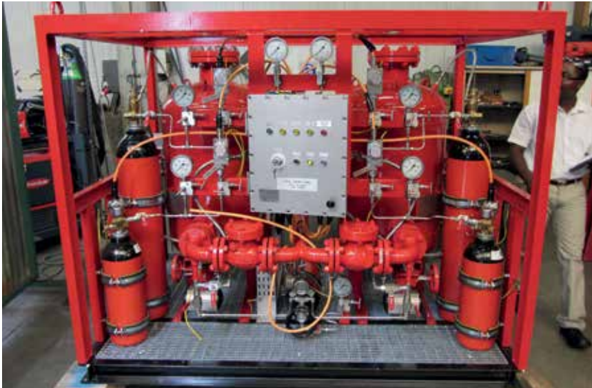
Transportables Feuerlösch-Skid mit explosionsgeschützter Steuereinheit
