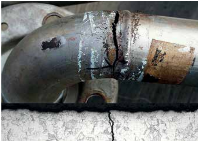
Schadensfall: Rohr aus nichtrostendem Stahl mit chloridbedingter Spannungsrissskorrosion.
