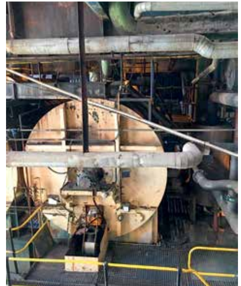
Kristallisatoren werden regelmäßig mit heißem Dampf gereinigt, um die Zuckerkristalle von den Behälterwänden zu lösen. Für Messgeräte ist dies schon ein erster Härtestest.
