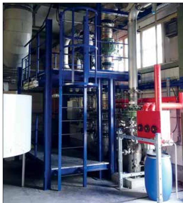
Anordnung der Flammensperren in den Abluftleitungen: Zwei parallele Stränge mit je zwei Sperren werden durch eine Notabführung (rechts) ergänzt.
