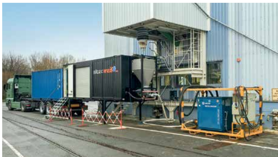
Delta-Blower-Einheiten von Aerzen sorgen als dezentrale Einheiten für die Förderluft des Siloadmaxx-Systems.
