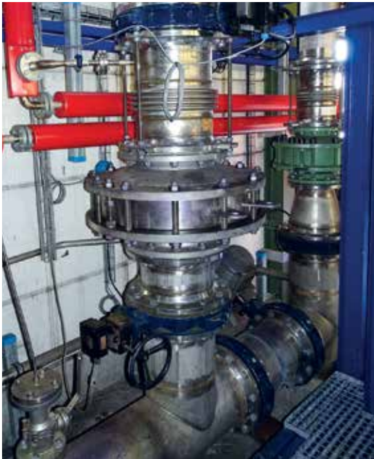
Jede Flammensperre kann mit zwei manuell bedienbaren Klappen für die Wartung und Reinigung isoliert werden. Dabei wird über den Kugelhahn am Rohrkomparator oberhalb der Sperre Heißdampf (rote Zuleitung) eingeleitet.
