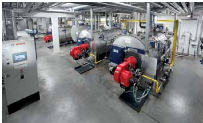
Die modernisierte Dampfkesselanlage bei Sutter spart durch die neuen Zweistoffbrenner und intelligente Steuerungstechnik jede Menge Brennstoff ein.
