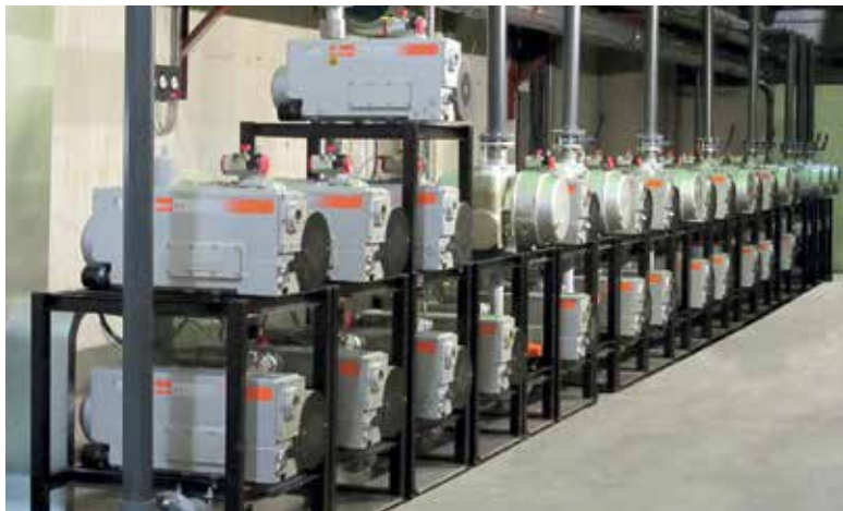
Die Module einer Vakuumzentralanlage für 30 Verpackungslinien mit Tiefziehverpackungsautomaten befinden sich außerhalb des Verpackungsraums.
