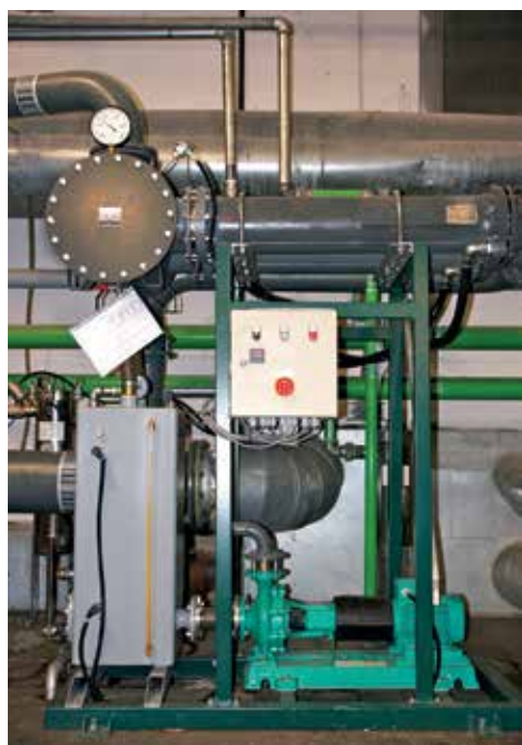
Durch den Wärmetauscher läuft der aus den Formteilautomaten abgesaugte Dampf und kondensiert dort zu großen Teilen. Danach erreicht er die Vakuumpumpe.
