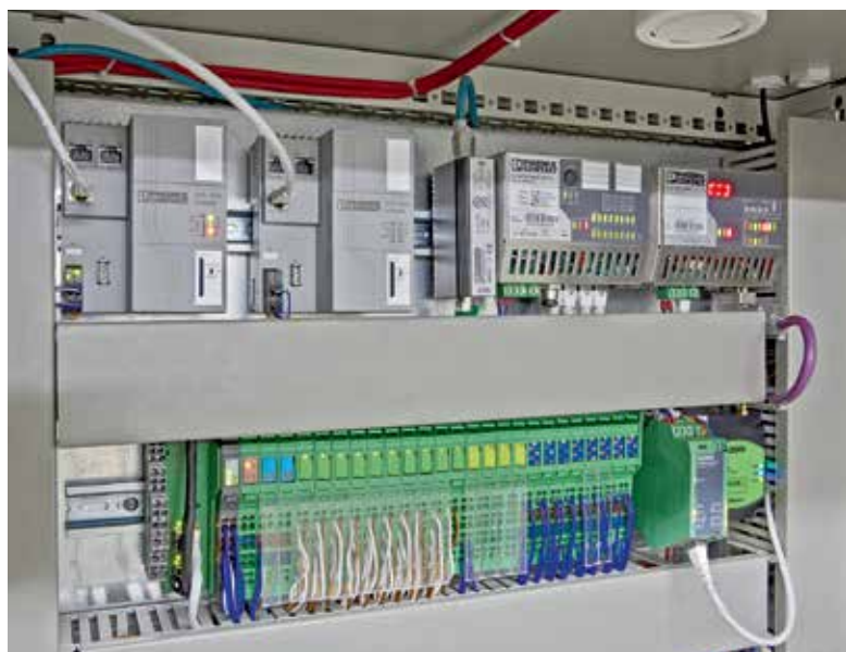
Die Profinet-Steuerung AXC 3050 von Phoenix Contact dient als Bindeglied zwischen den Feldgeräten und der Leittechnik.
