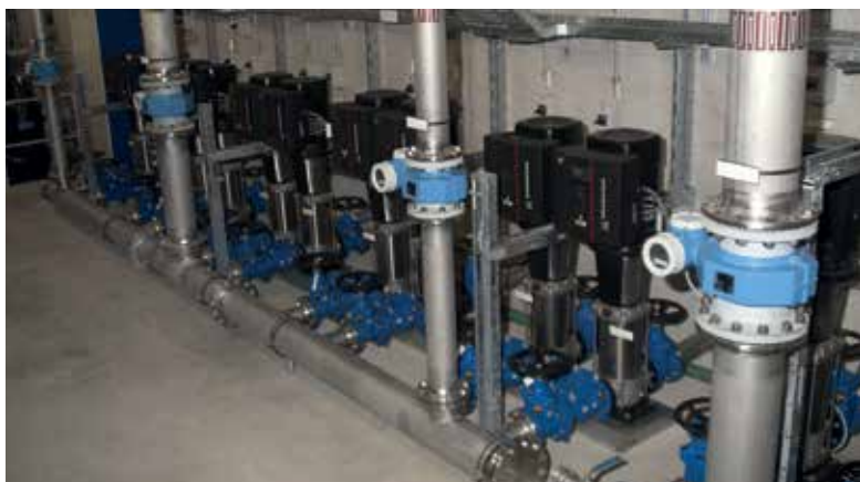
In Stapelbecken 8 sind insgesamt zehn Pumpen des Modells CRNE 64-4 in Reihe geschaltet und fördern das Abwasser zur Beregnungsanlage.
