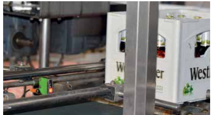
Die Fördertechnik in der Westheimer-Brauerei wird über speicherprogrammierbare Steuerungen (SPS) kontrolliert und gesteuert – Informationen liefern Reflexlichttaster und Lichtschranken.
