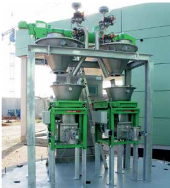
Im Klärwerk Dülmen kommt eine mechanisch Tara-kompensierte, gravimetrische Dosierung mit zwei Differentialdosierwaagen zum Einsatz.
