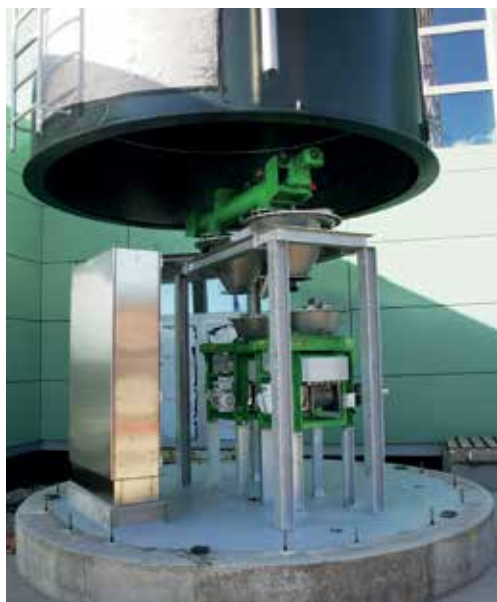
Die Nachfüllung erfolgt aus einem Vorratssilo über eine Zellenradschleuse und eine reversierbare Förderschnecke in die Vorbehälter.
