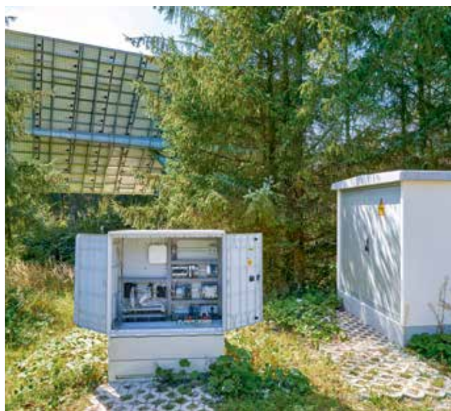
Über die im zentral angeordneten Schaltschrank befindliche Mastersteuerung werden die 22 Slavesteuerungen an den PV-Trackern angesteuert.
