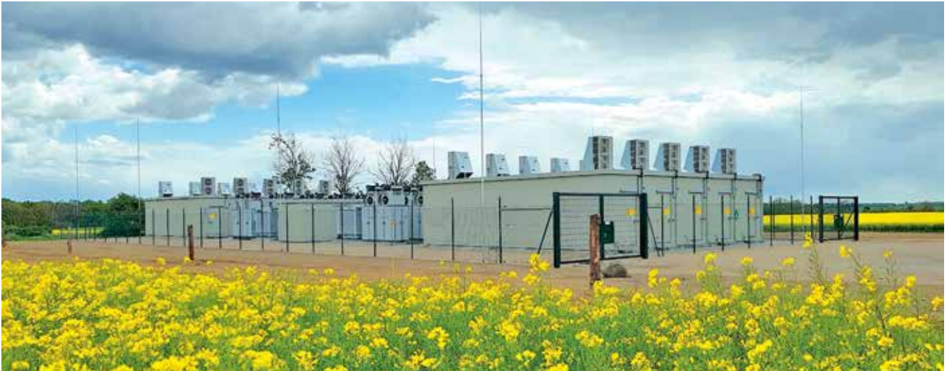
Die 22-MW-Gigabatterie stabilisiert seit Mai 2019 das Netz, indem sie etwa bei sinkender Netzfrequenz Strom ins Netz abgibt.
