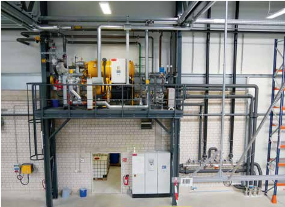
Platzsparender Standort: Unterhalb der Hallendecke wurde das Abwärmesystem untergebracht. Dazu gehört die kompakte Absorptionskälteanlage (AKA) vom Typ Hummel mit den Ausmaßen von 2,34/2,15/1,08 m (L/H/B) und einem Betriebsgewicht von 2605 kg.
