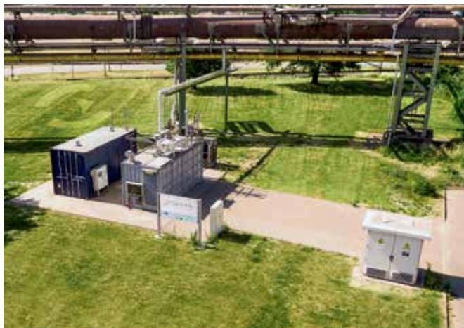
Mit dem Projekt GrInHy2.0 wird erstmals im industriellen Umfeld eine Hochtemperatur-Elektrolyse mit einer elektrischen Nennleistung von 720 kW realisiert.
