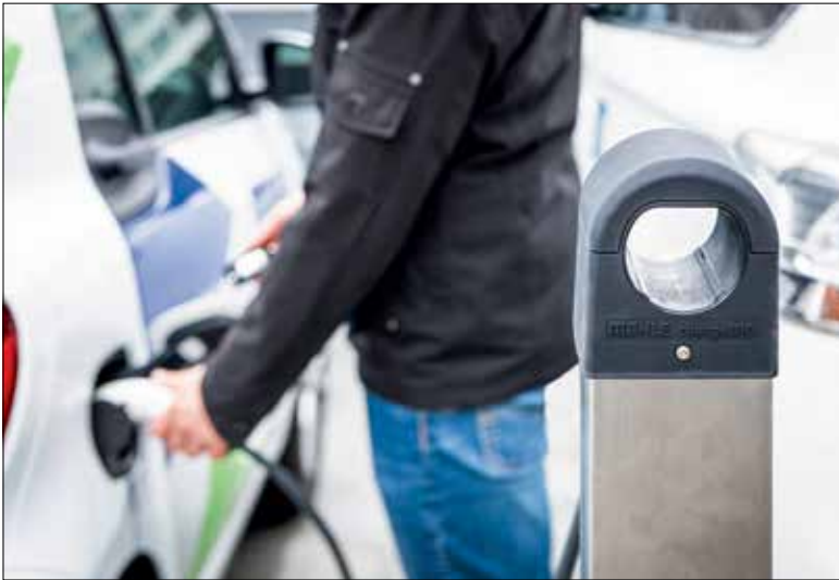
Das Ladesystem besteht aus einer zentralen Steuereinheit inklusive fest angeschlossenen Kabeln mit Steckern anstelle von Ladesäulen am Parkplatz.
