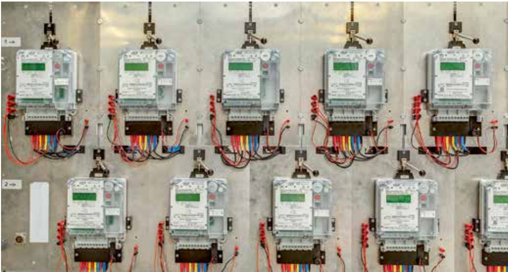
Zukunftssicher: Der RLM-Zähler LZQJ-XC lässt sich in ein intelligentes Messsystem integrieren, sobald die G2-Gateways auf dem Markt sind.
