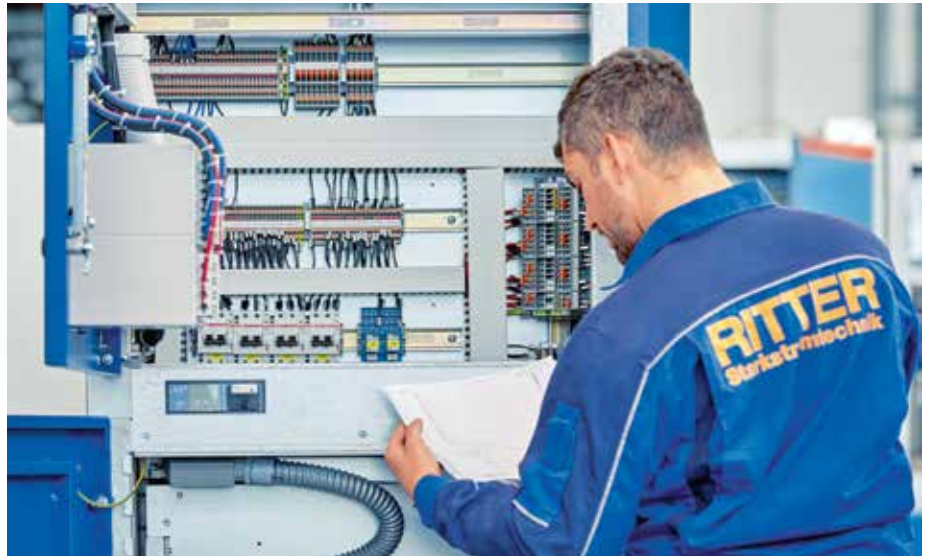
Die vorkonfektionierten Klemmenleisten in den Schaltanlagen von Ritter Starkstromtechnik.
