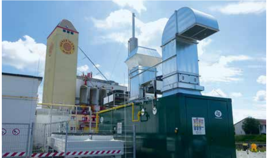
Das H 2 -BHKW Agenitor 406 SG von 2G dient zur Rückverstromung von Wasserstoff, der im Rahmen des PtG-Konzepts aus Windkraft mit Hilfe eines Elektrolyseurs gewonnen wird.
