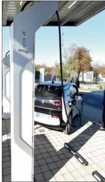
Die Schnellladesäulen haben eine Ladeleistung von je 150 kW.
