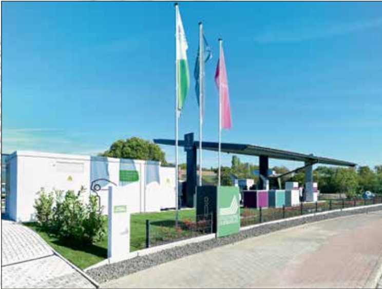
Im Ladepark Duisburg stehen vier Schnellladesäulen zur Verfügung. Das 180 qm große Solardach liefert 26.000 kWh Ökostrom im Jahr.
