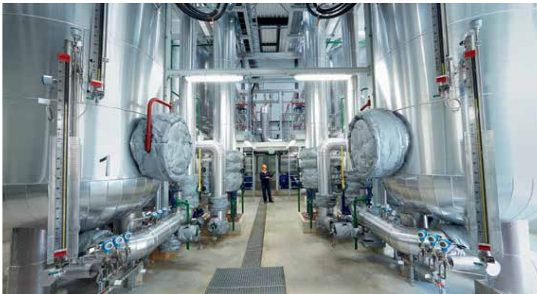
Power-to-Heat-Anlagen wie beispielsweise Wien sie betreibt, sind wichtige Puffer für die immer volatilere Stromerzeugung.
