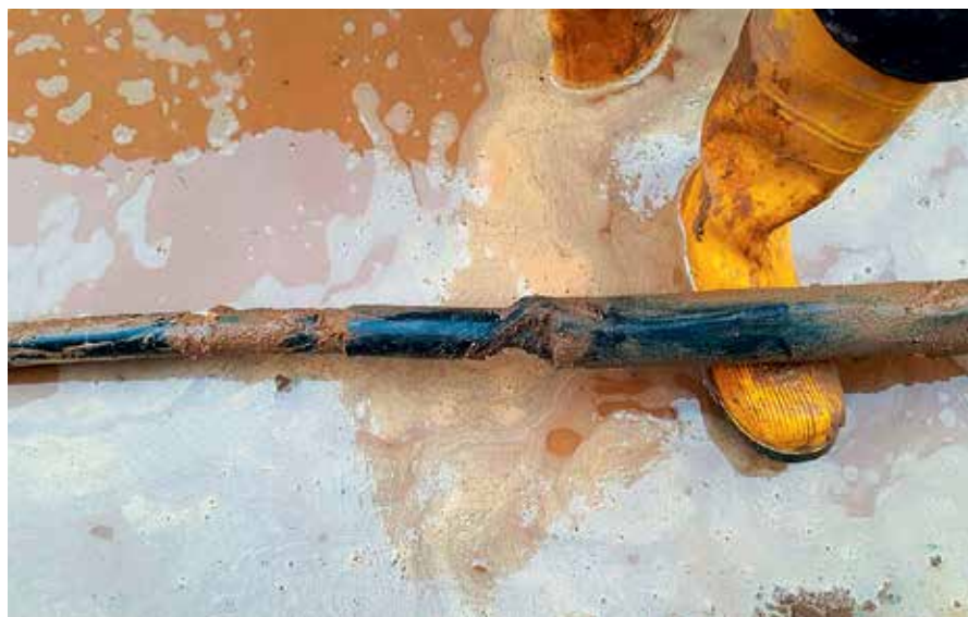
Ein Kurzschluss, der durch einen Kabelschaden verursacht wird, entsteht in der Regel zur kälteren Jahreszeit.
