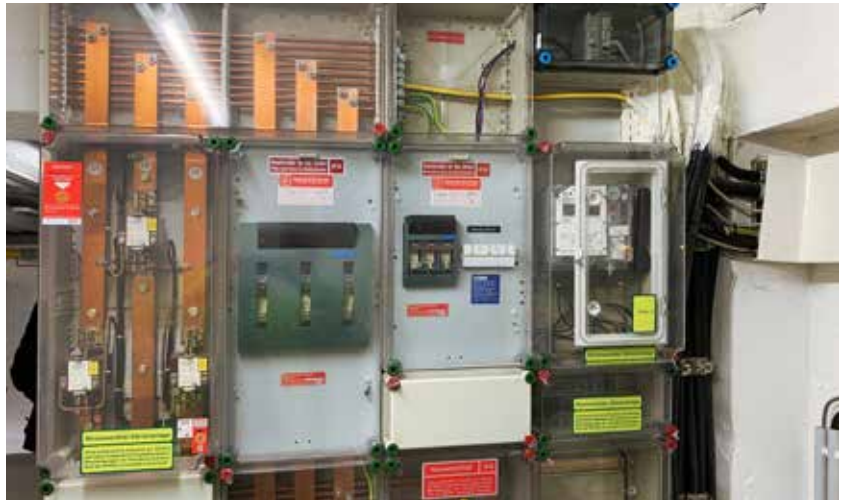
SPD in der Einspeisung und Überwachung mit ImpulseCheck
