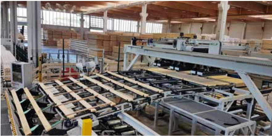
An den Ladenburger-Standorten sind insgesamt 109 Messstellen in econ4 integriert. Die Messgeräte erfassen Strom, Gas, Druckluft, Wärme, Leim- und Pelletmengen.
