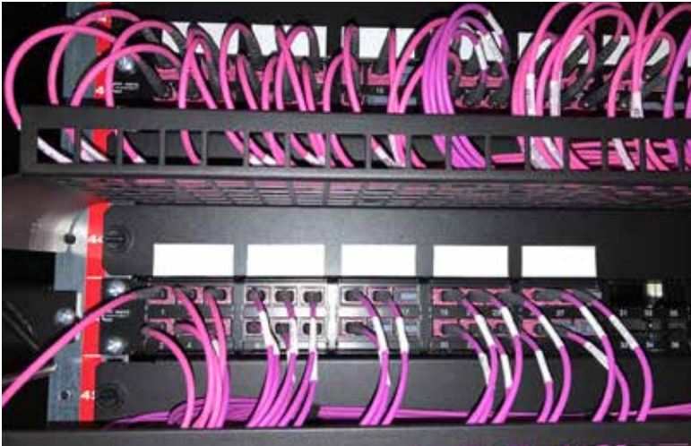
Einsatz der LWL-OpDAT MTP Komponenten in einem Rechenzentrum
