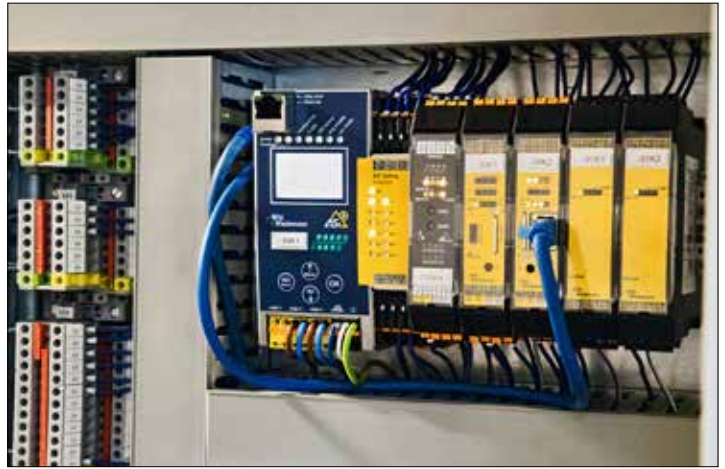
Sicherheitstechnik im Schaltschrank: ASi Safety Gateway (links) und Safety Basis Monitore (Mitte) von Bihl+Wiedemann
