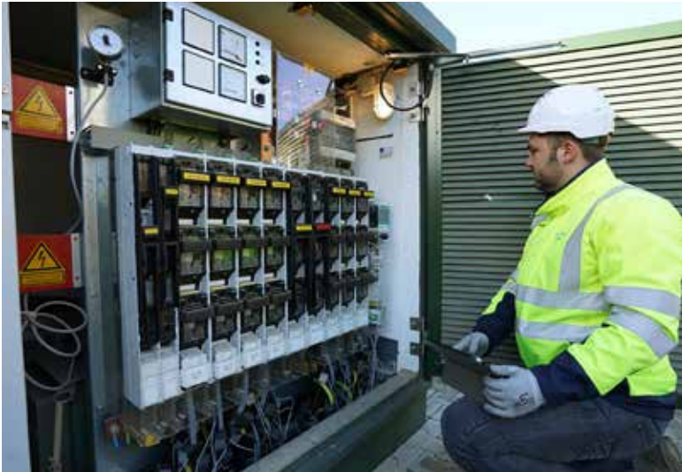
Der digitale Zwilling und die Kontrolle der Stationswerte erfolgen bei der Inbetriebnahme der digitalen Ortsnetzstation.
