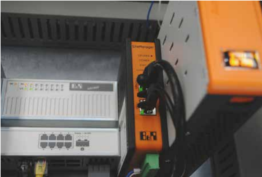
Die B&R-Fernwartungs-Hardware, der sogenannte SiteManager, muss lediglich an der Maschine platziert werden und baut anschließend den Fernwartungs-Tunnel auf.
