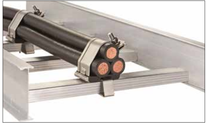
Die Kabelschellen von Panduit trotzten den starken Kräften, die bei Kurzschlüssen auftreten können.
