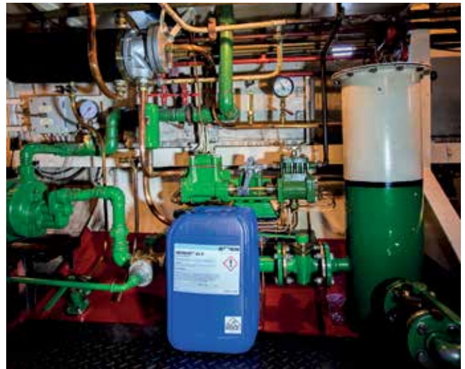
Für eine natürliche Kesselwasseraufbereitung wird dem Speisewasser auf der St. Georg Demkor 41 zugesetzt.
