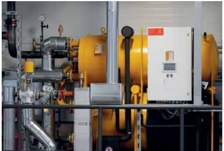
Die Absorptionsanlage Hummel weist ein Leergewicht von 1.860 kg auf, unter Betrieb wiegt sie etwa 750 kg mehr.
