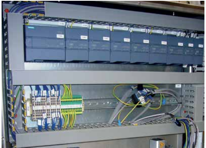
In dem Schaltschrank sind die Wägemodule Siwarex WP251 installiert.
