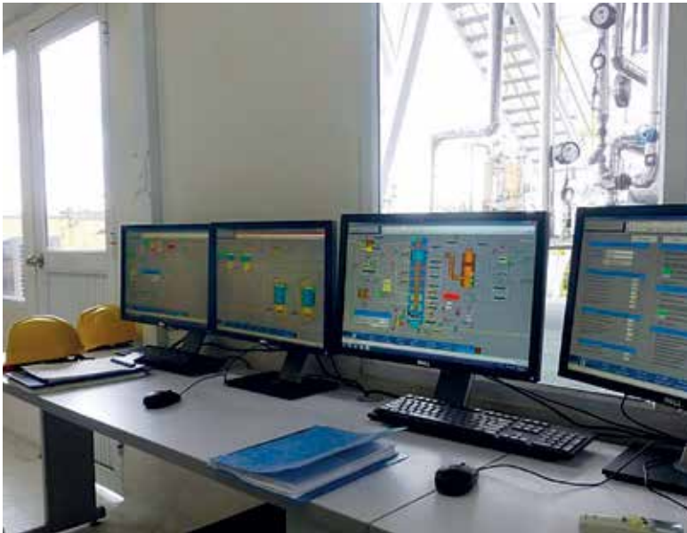
Bei PlantPax läuft die gesamte Netzwerkkommunikation über ein einziges Ethernet/IP-Protokoll anstelle von bisher drei Protokollen.
