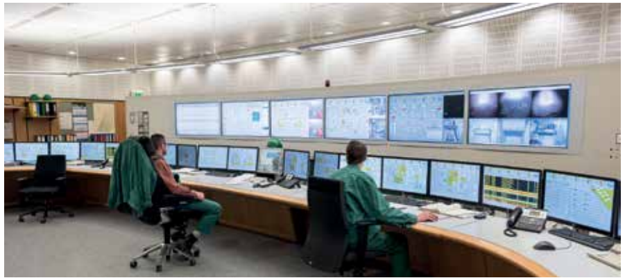
Das neue Prozessleitsystem erlaubt eine Integration der gesamten Gebäudeleit- und Schalttechnik, mit Komponenten unterschiedlichster Hersteller.
