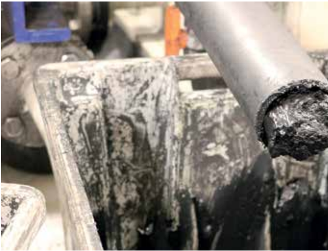
Der entwässerte Schlamm wird in kleinen Containern zwischengelagert und anschließend auf dem Festland fachgerecht entsorgt.
