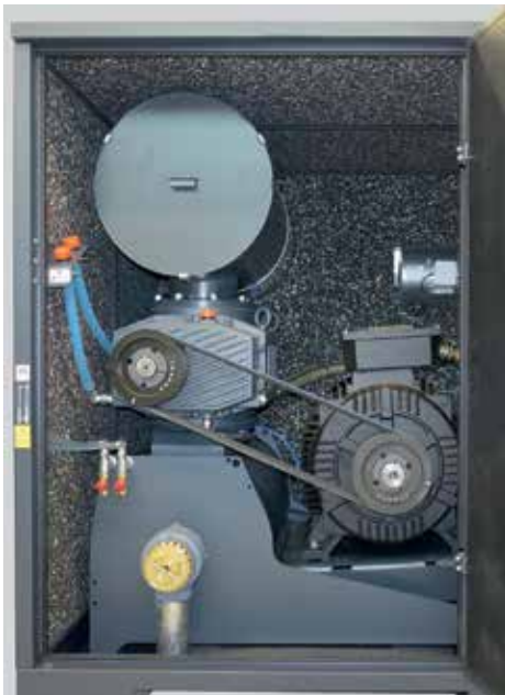
Blick in die geöffnete Schall-dämmhaube eines Tyr-Drehkolbengebläses. Im Vordergrund die Öleinfüll- und Ablassöffnungen sowie die von außen sichtbaren Ölstand-Schaugläser.
