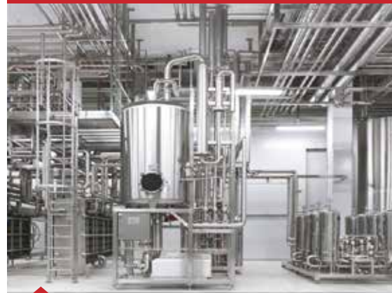
Entgasungsanlage für Getränke
