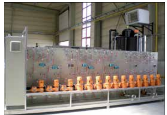
Dosiersystem zur Kühlwasserbehandlung
