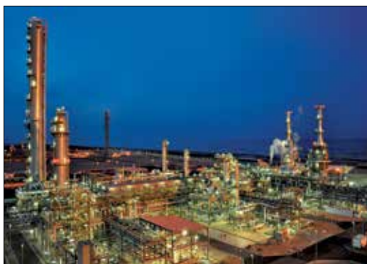
Ein Anlagenkomplex bestehend aus einer Propylen- und Polypropylen-Anlage in Port Said, Ägypten.
