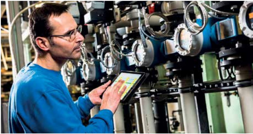
Ingenieure und Techniker von EnviroChemie betreuen im Rahmen eines Betriebsführungs-Contractings die Anlagentechnik zur Abwasserbehandlung.
