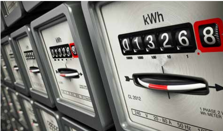
Energiesparen lohnt sich und das lässt sich zum Beispiel am Stromzähler direkt ermitteln.
