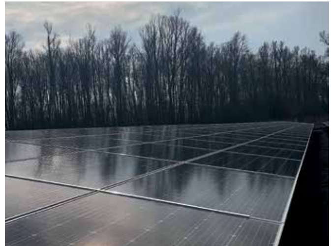
Insgesamt 7.200 Module sorgen in der dortigen Wasseraufbereitungsanlage für grünen Sonnenstrom.
