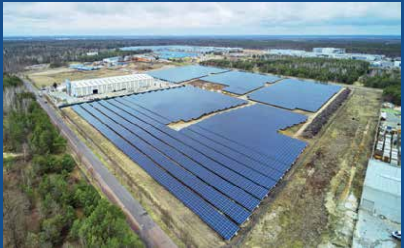
Das 10-MW-Kraftwerk im Dessora-Industriepark ist eine Pilotanlage für die Reglerfunktion Q@Night.
