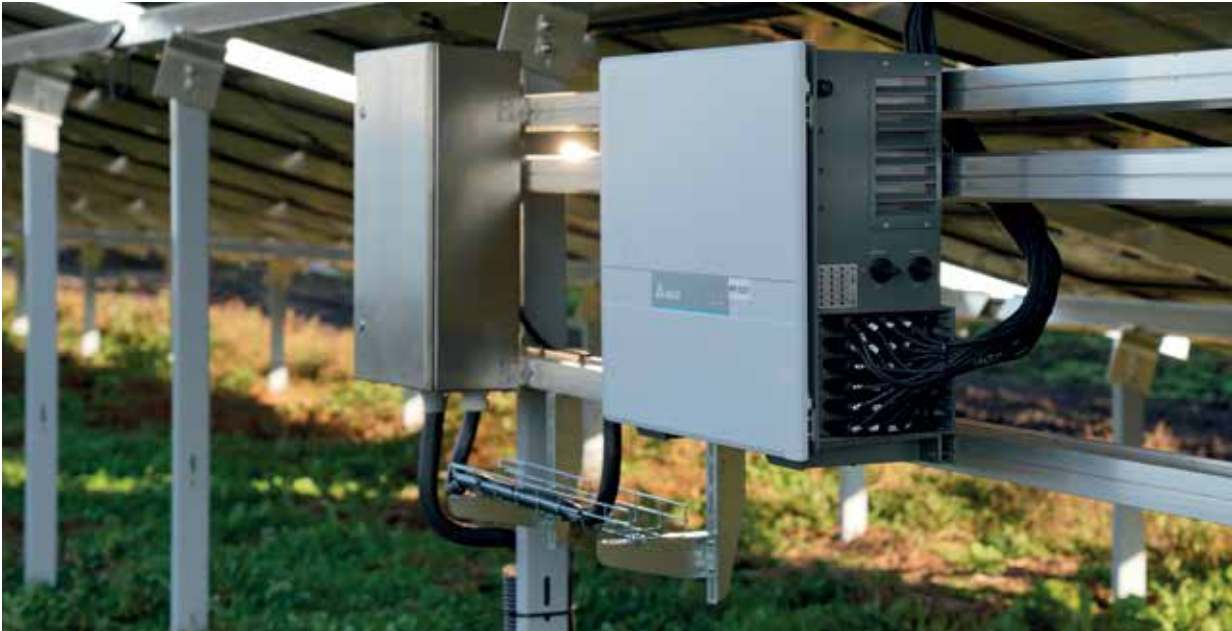
Über 1.500 M70A-String-Wechselrichter von Delta wandeln den Gleichstrom der Solarmodule in 400-V-Wechselstrom um.
