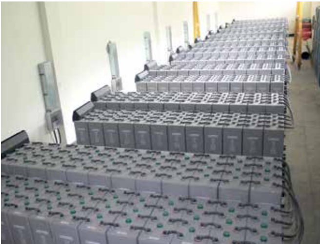
Neun Cluster Batteriepufferspeicher mit einer Gesamtkapazität von 1.512 kWh halten den Strom zu jeder Zeit bereit.
